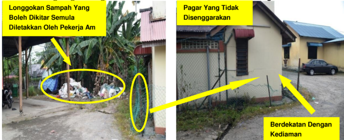
Gambar 2.4 Tempat Simpanan Kenderaan Yang Tidak Terurus Dan Sekeliling Pagar Yang Mudah Dicerobohi Serta Berdekatan Dengan Kediaman
