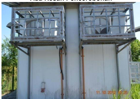
Gambar 4.1 2 Unit Penghawa Dingin Dicuri Dan Ada Kesan Pencerobohan
