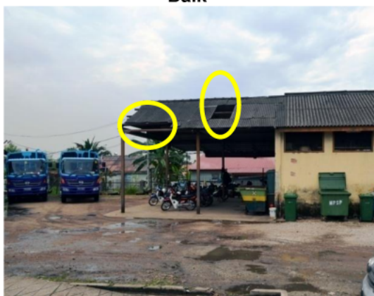
Gambar 2.2 Bumbung Tidak Disenggarakan Dengan Baik
